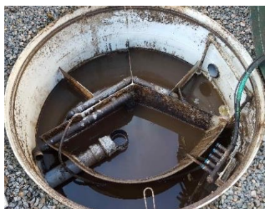
Dysfonctionnement - Présence de boue dans le rejet
